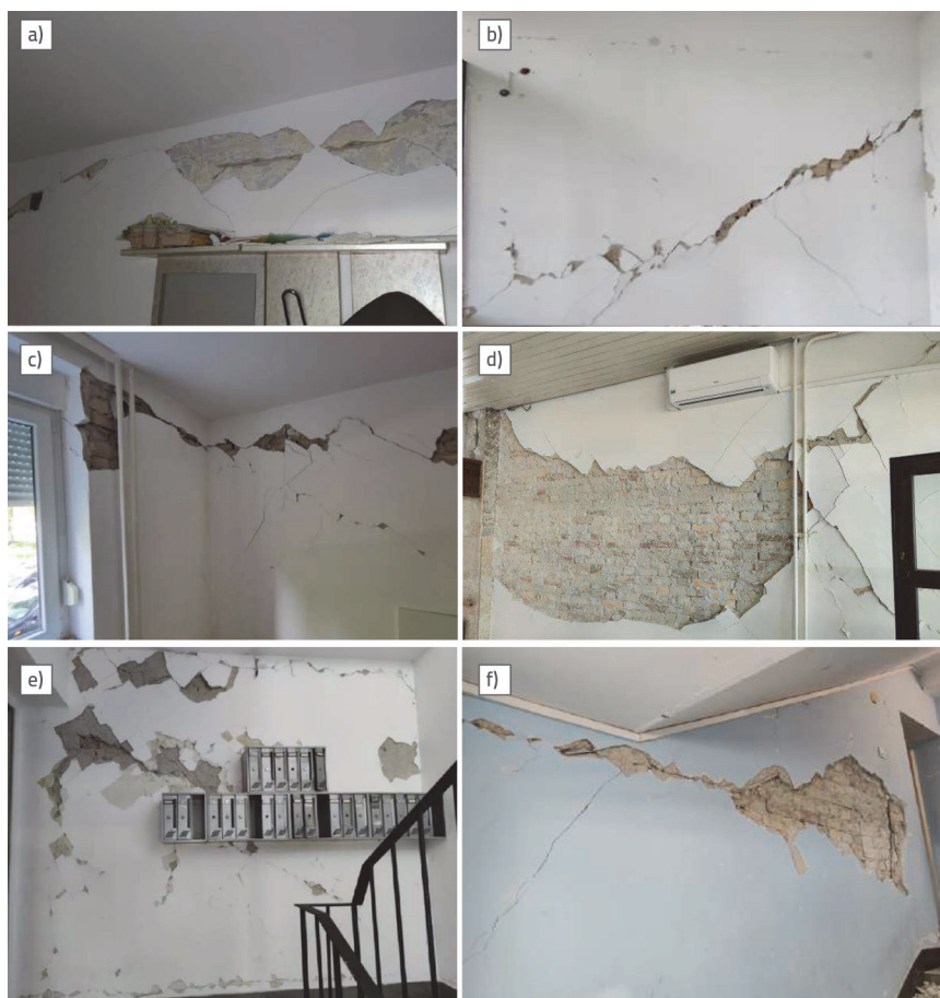
Slika 8. Pukotine nosivog zida: a) oštećenje uzdužnog zida POZ 1, b) oštećenje poprečnog zida POZ 2, c) oštećenje ugla zida POZ 3, d) oštećenje poprečnog zida POZ 4, e) oštećenje uzdužnog zida POZ 5, f) oštećenje poprečnog zida POZ 6
